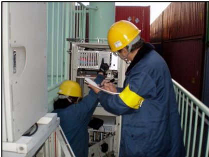
通信設備点検業務
