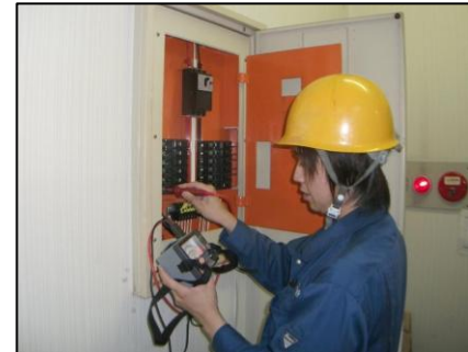
電源設備点検業務
