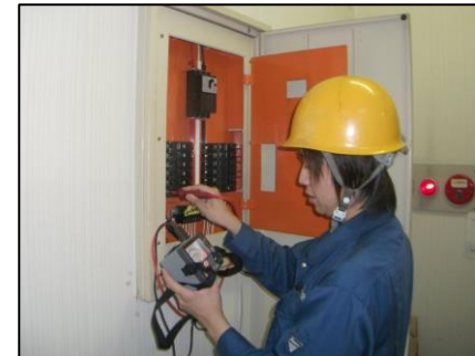
電源設備点検業務
